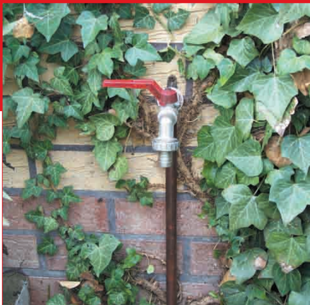
Abb. 6.1 – Wasseranschluss an der Hauswand
