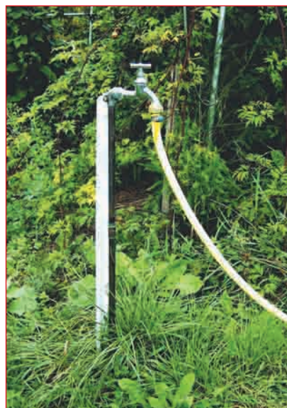
Abb. 6.2 – Freistehender Wasseranschluss im Garten
