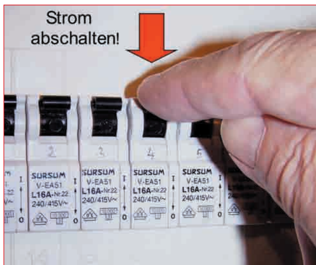
Abb. 7.3 – Bei wenigen handwerklichen Arbeiten lässt sich die Verletzungsgefahr so leicht eindämmen wie bei der Arbeit mit elektrischem Strom: Eine Handbewegung genügt und der Strom ist abgeschaltet – und das bleibt er, bis man ihn wieder einschaltet.
